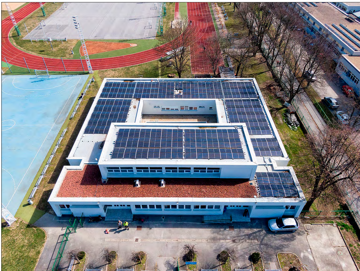
📍 Dodatak 2. Instalirana solarne elektrane snage 93 kW na zgradi Srednjike u Osijeku u okviru projekta GReENERGY.
